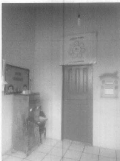
Imagem 2 – Pintura interna e esquadrias da escola.
